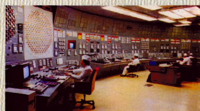
Щит управления Смоленской атомной электростанции
